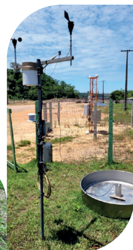
Equipamentos instalados na Estação meteorológica UHE Teles Pires
