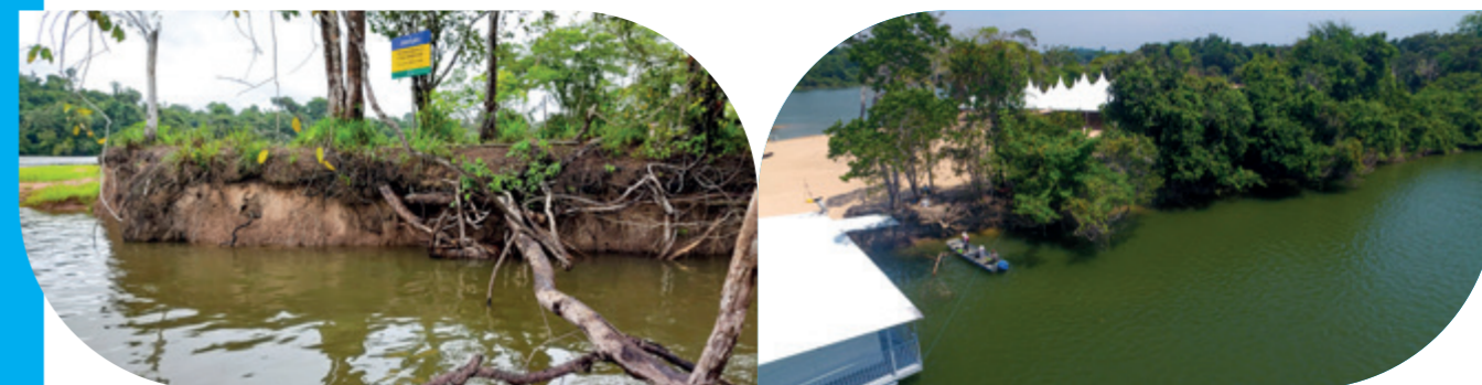
Trecho MI-2 observado em novembro de 2021 (à esquerda) e revisitado já com construções em agosto de 2022 (à direita)
