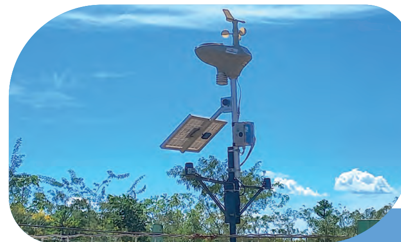
Equipamento da estação meteorológica
